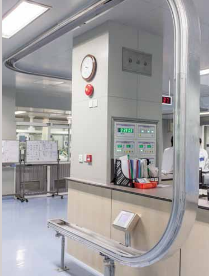
Telelift Systeme im Krankenhaus
